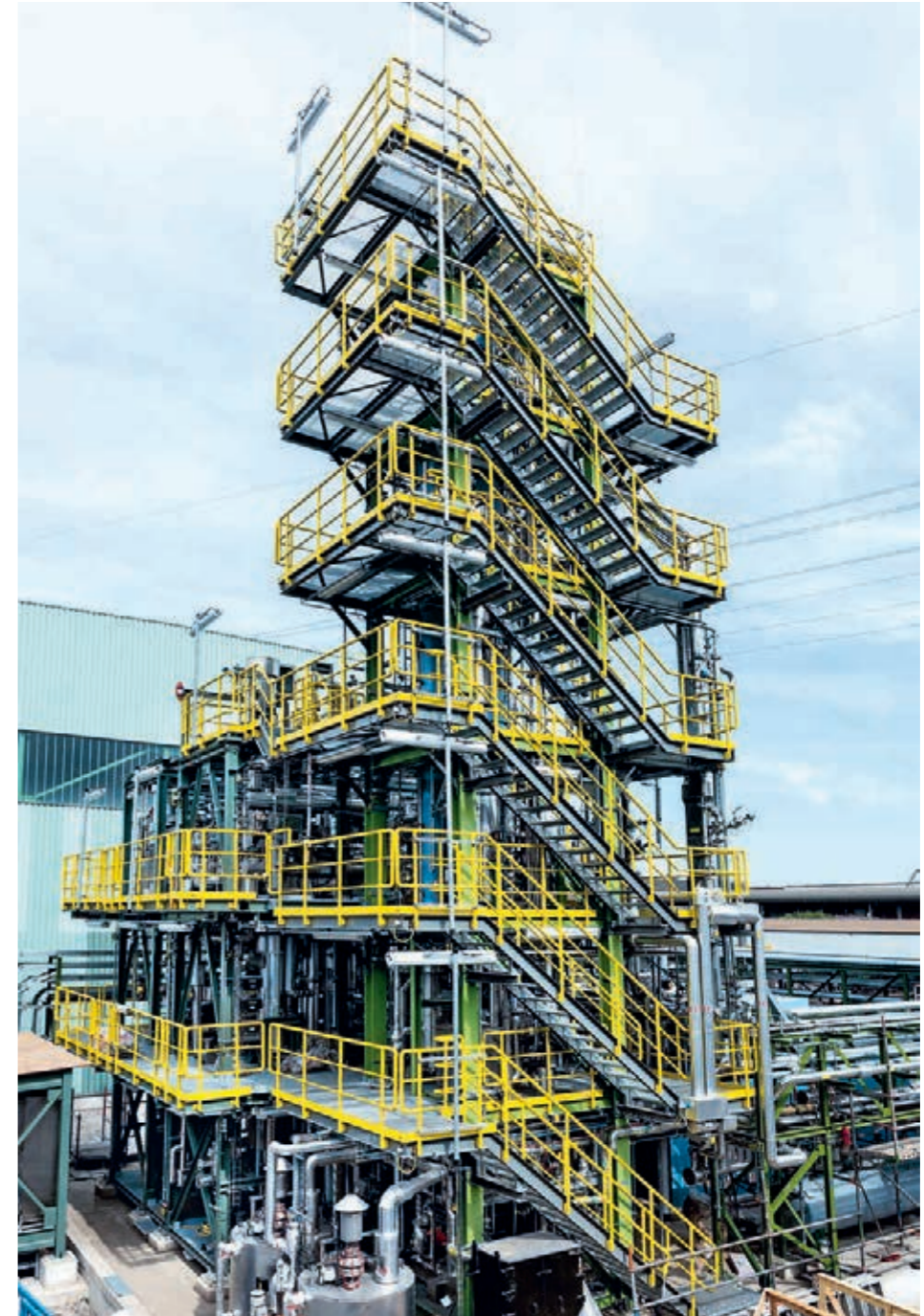
Anlage zur Gasreinigung: Das Duisburger Stahlwerk von ThyssenKrupp hat die Ausmaße einer mittleren Stadt.
